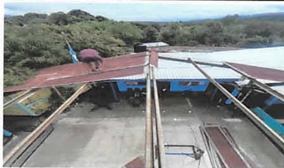
Foto 4: TECHO DE GALERA EN MAL ESTADO
