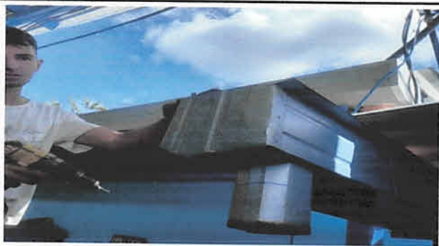
Foto 1: CANALES EN MAL ESTADO DE LA GALERA
