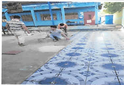
Foto 5: PISO DE CONCRETO EN MAL ESTADO
